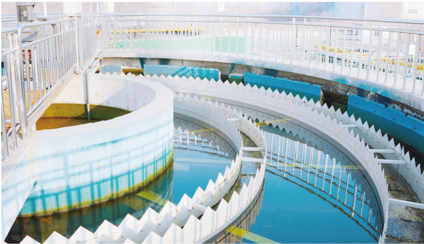
杨村煤矿生活污水处理系统。
